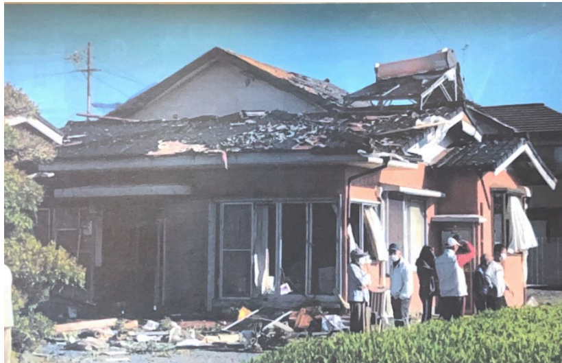
図 3 竜巻の被害を受けた家屋（撮影：牧之原市 2021）
